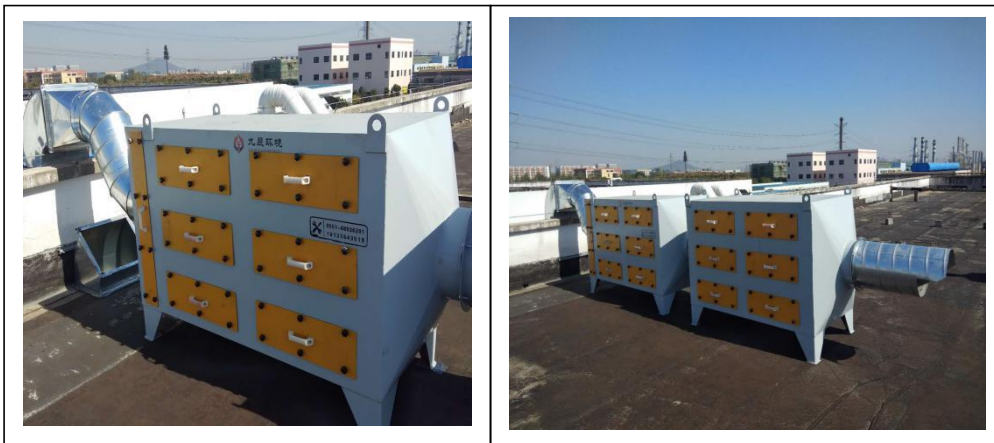
活性炭吸附装置及配套排气筒
