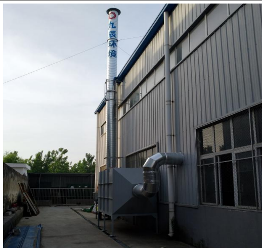
活性炭吸附装置+15m 高排气筒
