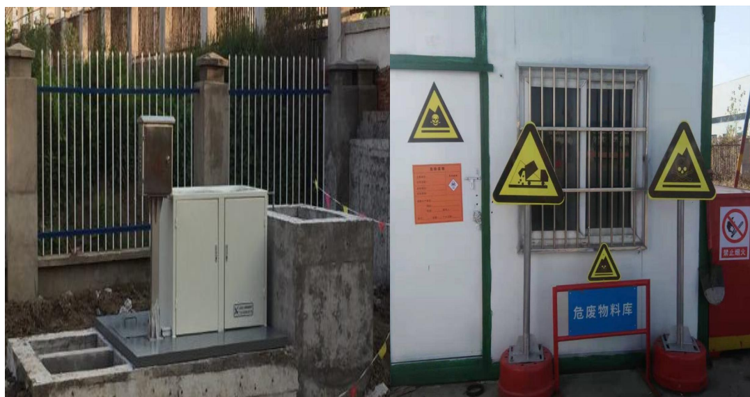
洗车废水处理装置
