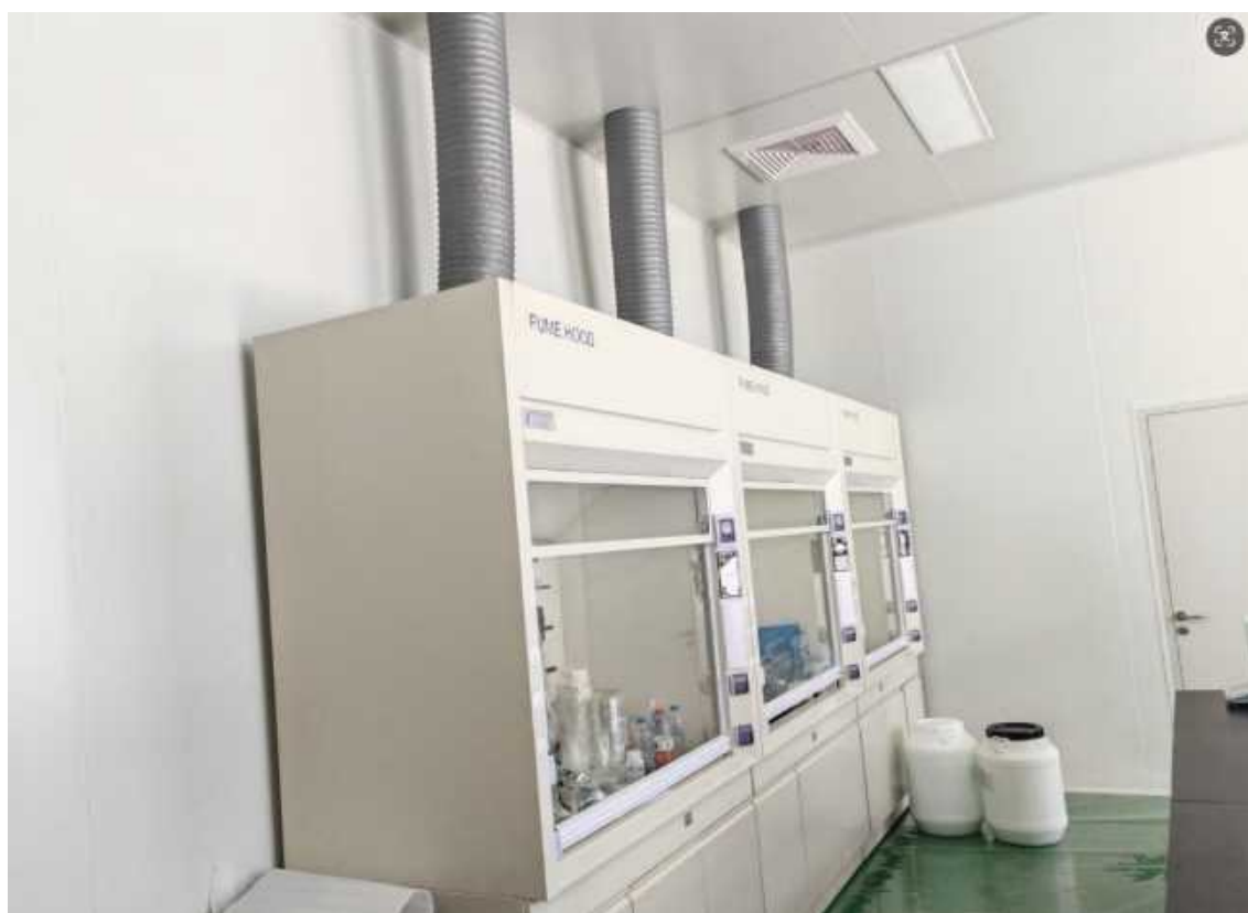
废气收集系统（密闭房间+通风橱收集系统）
