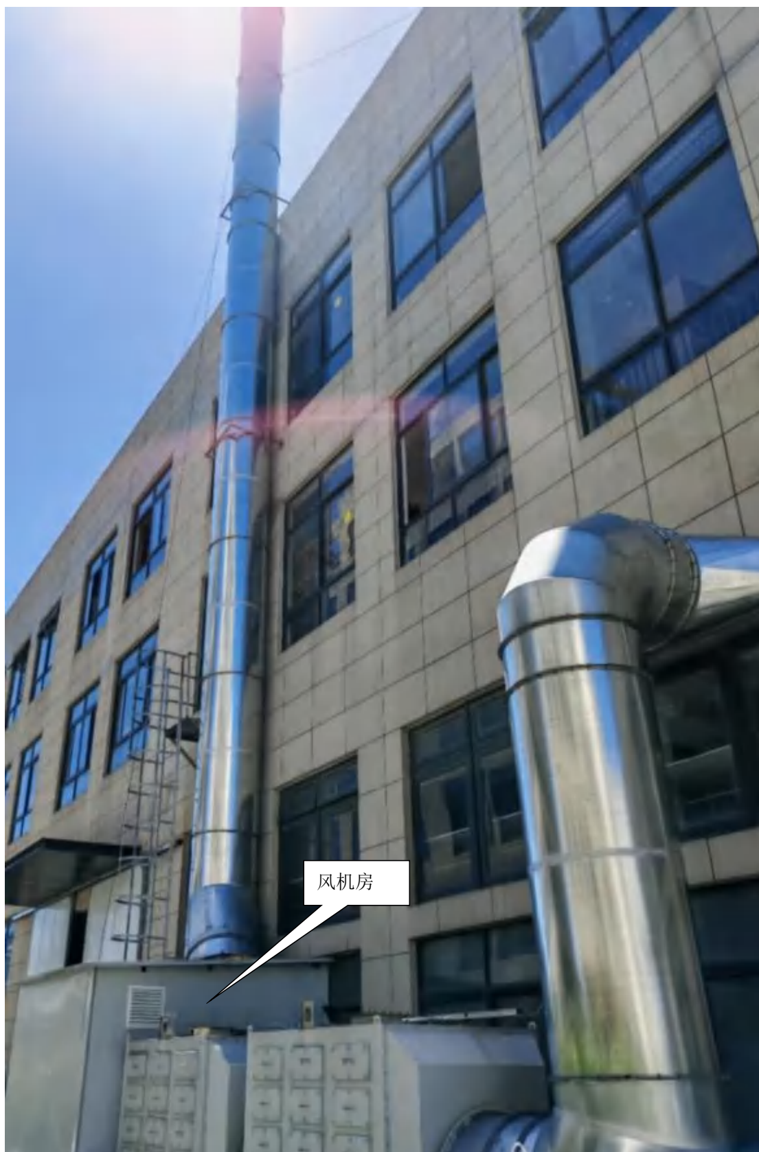
两级活性炭吸附装置+25m 高排气筒（配套隔声风机房）
