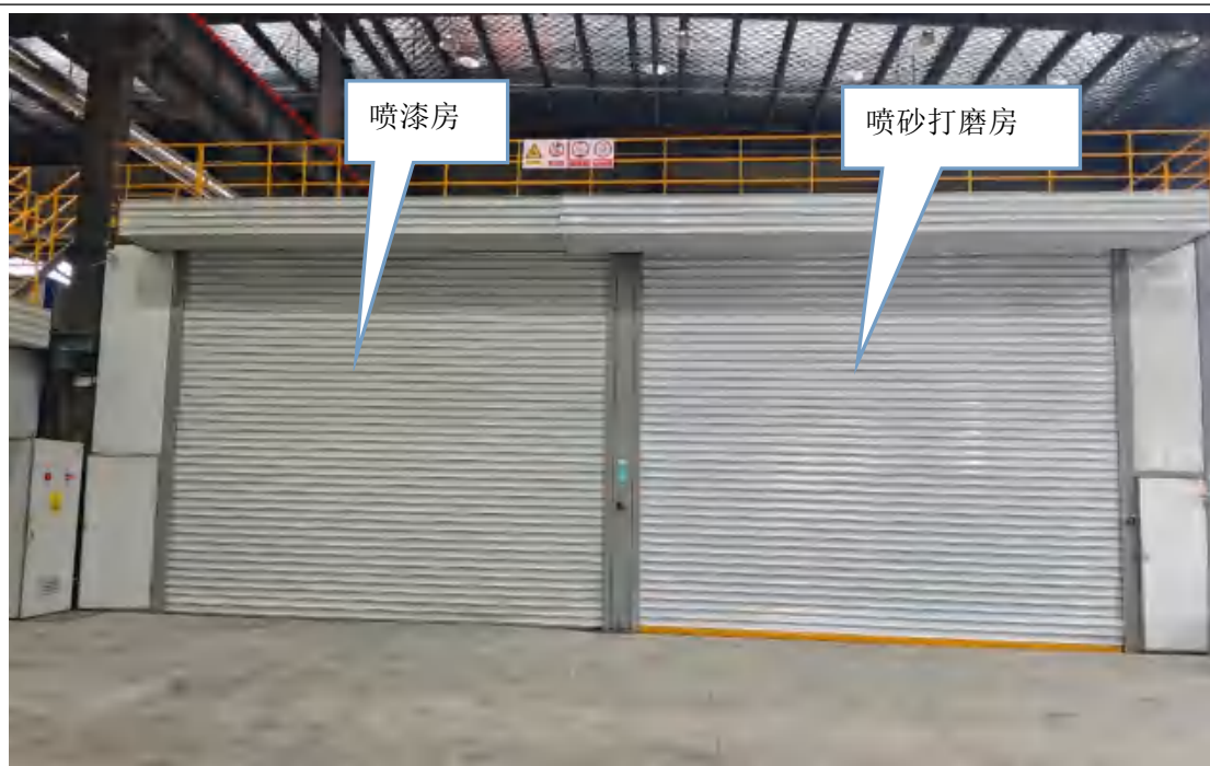
密闭喷漆房、喷砂打磨房
