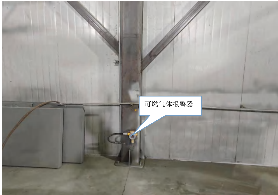
喷漆房（废气收集系统、可燃气体报警器）
