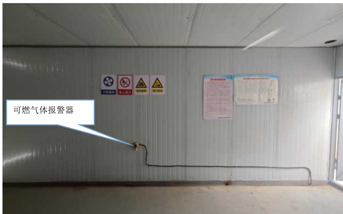
危废仓库（防渗地面、标识、防漏托盘、导流沟、可燃气体报警器）
