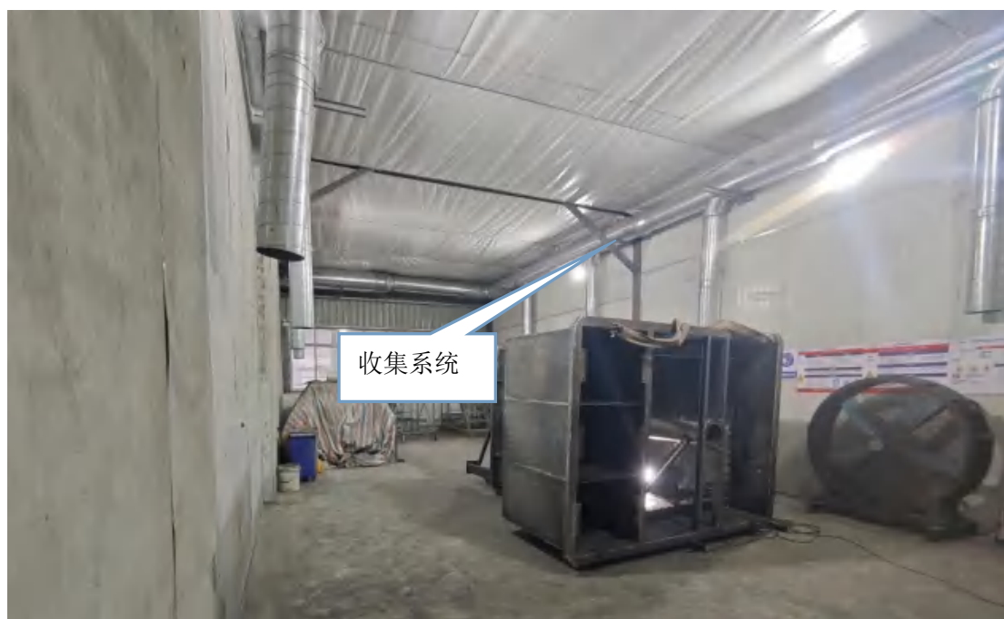
喷砂打磨房（废气收集系统、标识等）
